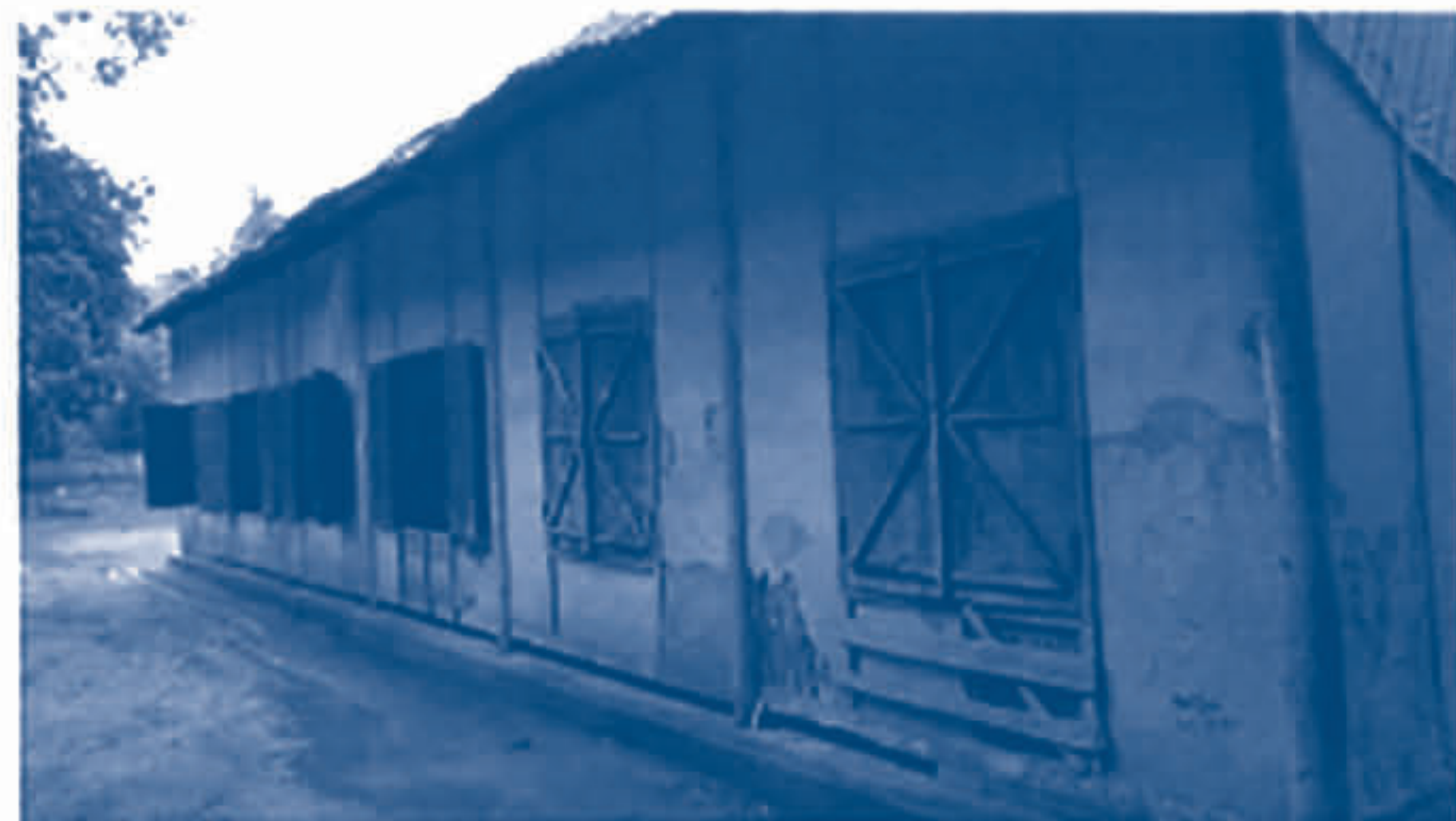
壁がボロボロで穴も開いている
