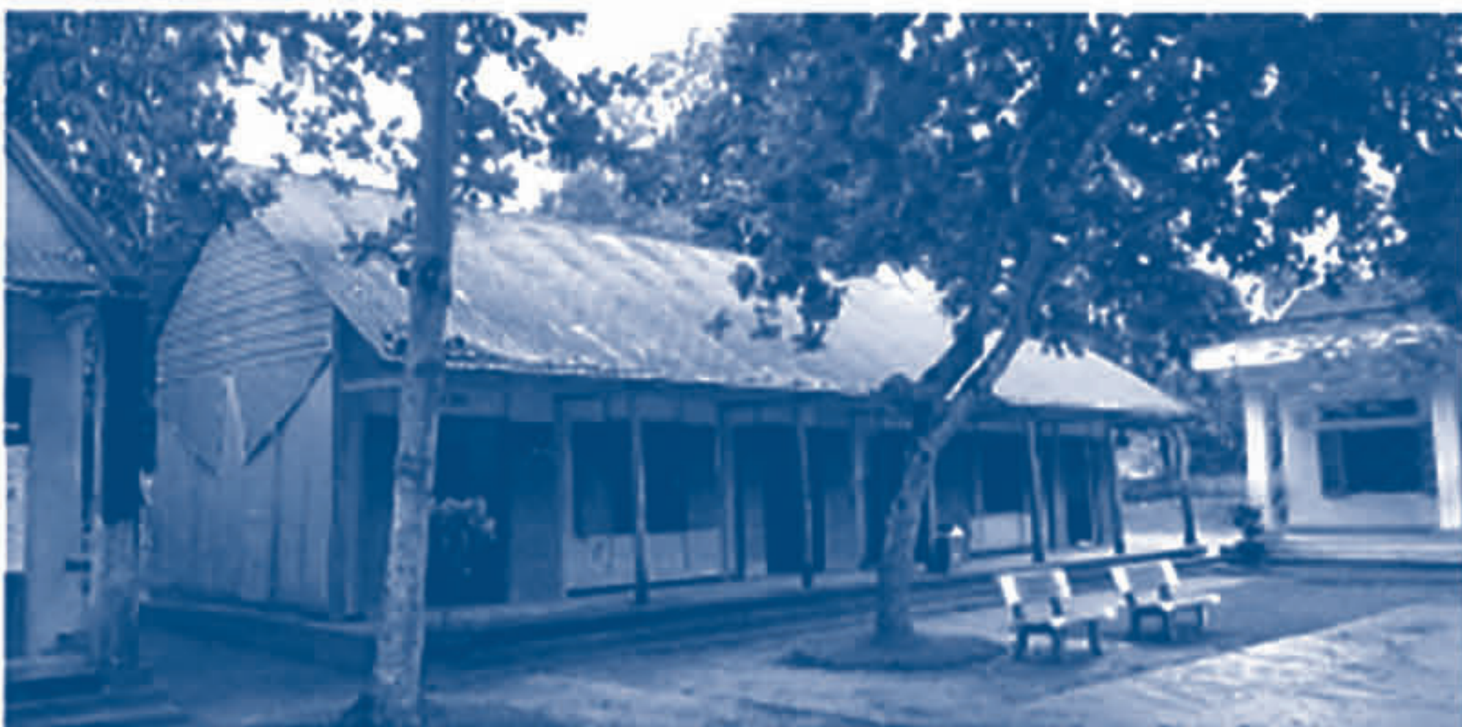
一部ビニールシートで穴をふさいでいる
